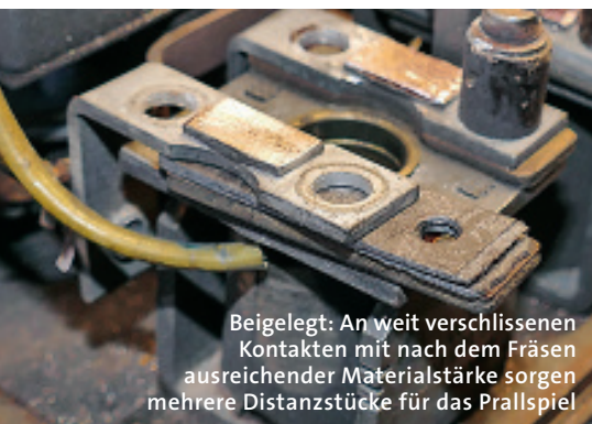
Ausgeglichen: Mit einer Beilage aus nicht leitendem Material wird das Prallspiel auf das entsprechende Sollmaß gebracht
